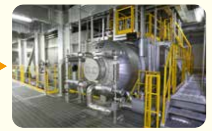
4 4 ボイラ 4 ボイラ ごみ焼却によって発生する排ガスの 熱をボイラで回収し、蒸気を生 させます。
