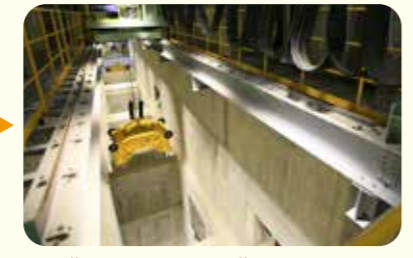
6 6 灰クレーン・灰ピット 6 灰クレーン・灰ピット 灰ピットに貯められた灰は、灰クレー ンにより焼却灰水洗装置へ送ります。
