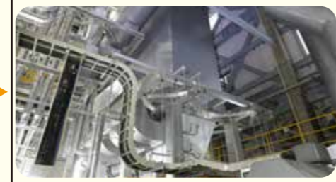
5 5 ろ過式集じん器 5 ろ過式集じん器 排ガス中のばいじん、塩化水素、硫酸化合物 及びダイオキシン類を取り除きます。
