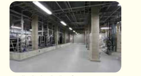
9 9 ばいすいしよりせつび 9 ばいすいしよりせつび 排水処理設備 プラント排水を生物処理・凝集沈殿・ 砂ろ過処理して、場内で再利用します。
