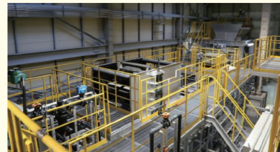
焼却灰水洗装置 Smash System
