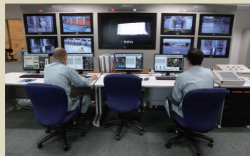
中央制御室 Central Control Room
