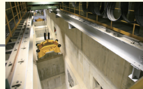
灰クレーン・灰ピット Ash Crane・Ash Pit
